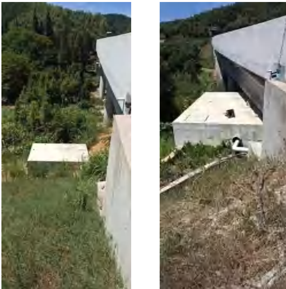
图 8-1 事故集水池设施
